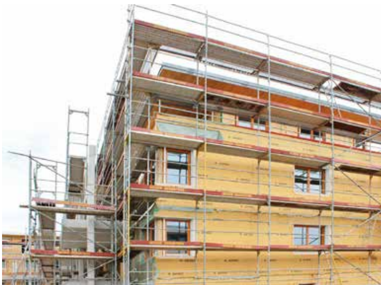
Brettsper Holzkonstruktion mit Holzfaser-WDVS bis zum 3. OG. Das zurückspringende Attikageschoss ist mit einer holzfasergedämmten, vorgehängten hinterlüfteten Fassade bekleidet
