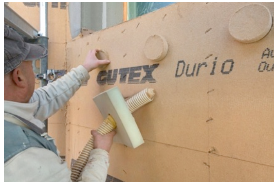
Einblasen von GUTEX Thermofibre durch geschulte und zertifizierte Holzbauer: Nachdem die Zwischenräume ausgedämmt waren, wurden die Einblasöffnungen mit einem speziellen Verschluss Pfropfen aus Holzfaser wärmebrückenfrei verschlossen.
